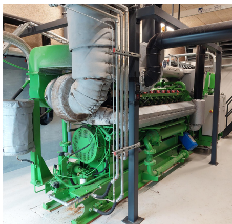
Gasmotor (CHP-enhed) hos Hærup Biogas.
